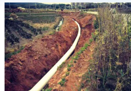
三明自来水公司供水管道
